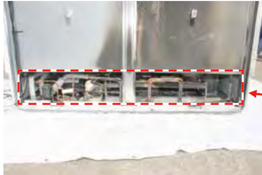
(写真6) 冷蔵ショーケース背面下部
