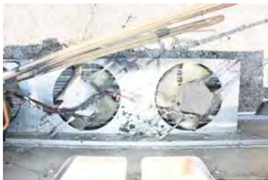
(写真8) コンデンシングファンの状況
