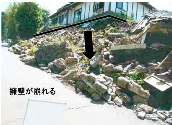
写真1(a) 全面的な崩壊が生じた空石積造擁壁
