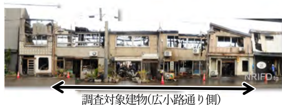
写真1 広小路通り沿いの火元建物の並びの建物(被災後)
