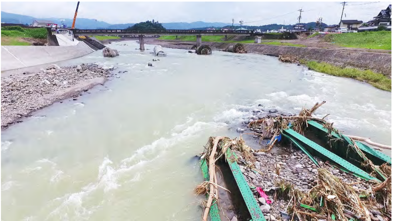
大分県日田市JR久大本線鉄道橋流出箇所 (7/8) (写真提供：国土交通省九州地方整備局)
