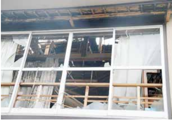
図9 飛び火で屋根を焼損した住宅
