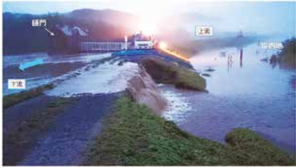
写真3 常呂川の越流時の状況 (日吉30号樋門、8月22日4時頃の状況) (北海道開発局網走開発建設部提供資料に加筆)
