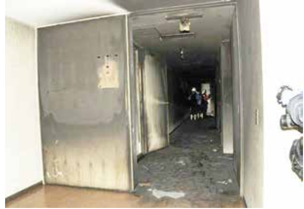
図10 建物内での延焼拡大と煙害を防いだ防火扉
