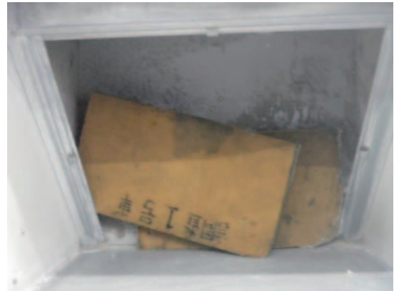
写真11 排気不良の再現
