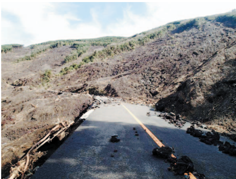
図5 崩壊発生源内を走る道路
