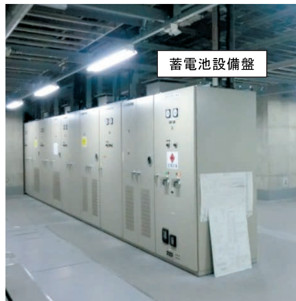
写真1 出火した電気室の状況
