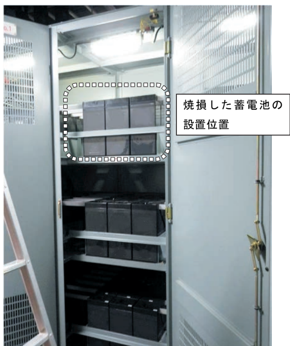
写真2 蓄電池設備盤内部の状況
