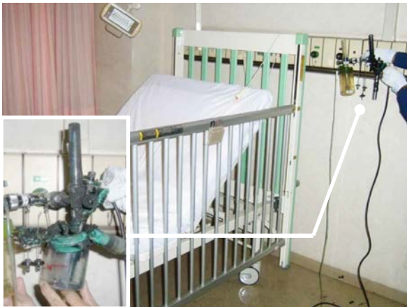
写真1 出火箇所の状況
