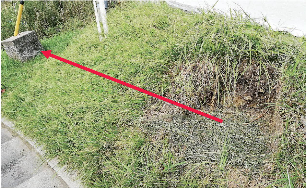
強風で移動したコンクリートブロック（千葉県館山市） 撮影日：2019年9月20日（金）
