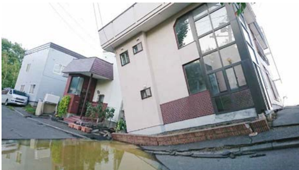
写真-4 被災地の状況（地点 c）
