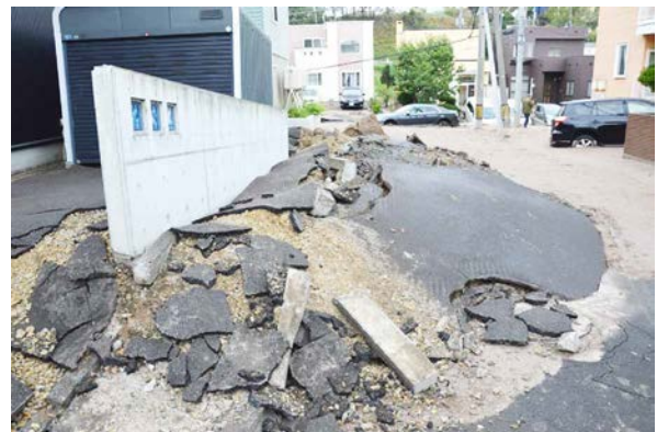
写真-6 被災地の状況（地点 e）
