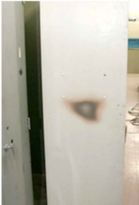
【写真2 焼損したキャビネットの側面】
