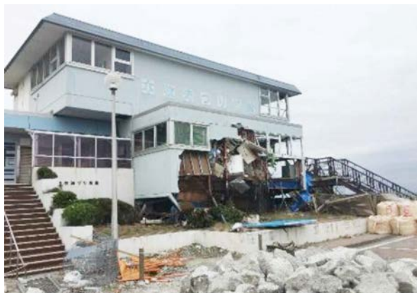
図-9 被災した本牧海釣り公園管理事務所
