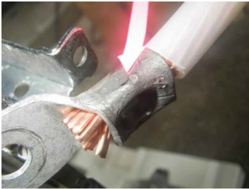
写真24 実験2回目丸型圧着端子の状況
