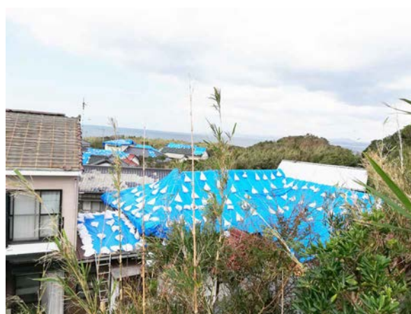
令和元年台風15号による被災家屋の様子
