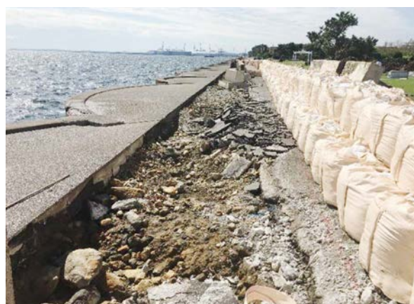
図-8 本牧横浜港シンボルタワー周辺における護岸の倒壊
