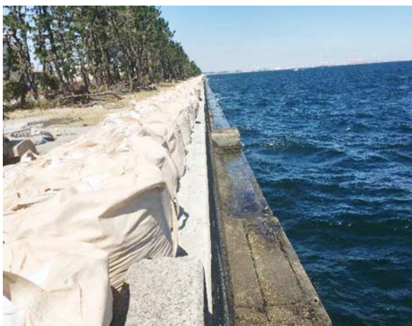
図-6 横浜市福浦地区での護岸の被災
