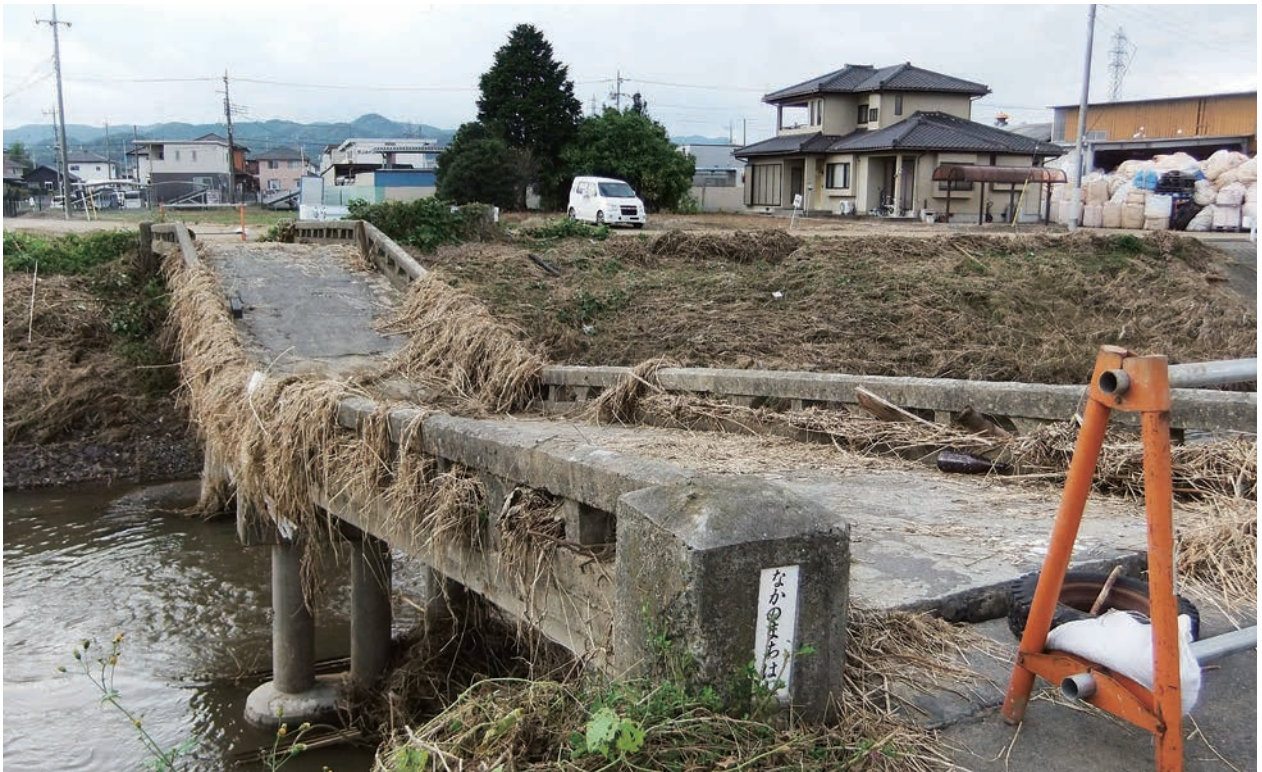
大きく折れ曲がった皆川地区の橋 写真提供：栃木県栃木市
