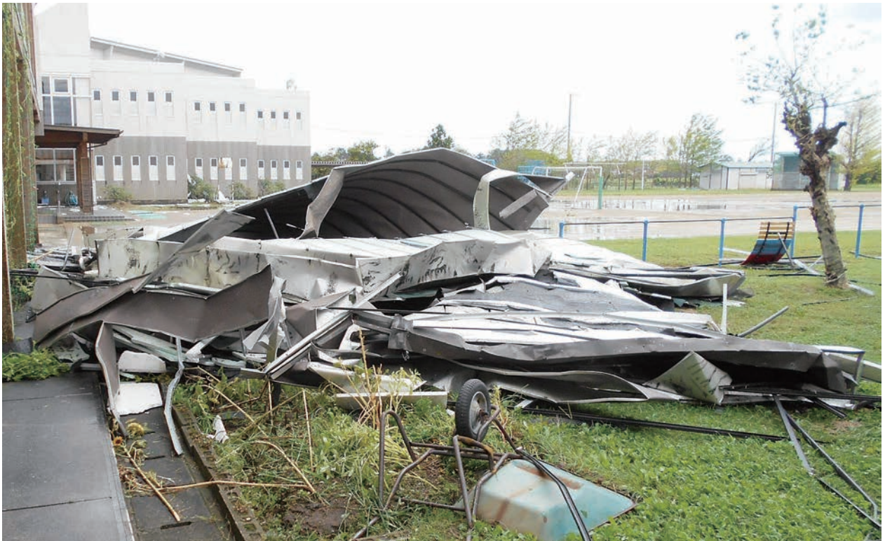
強風により校舎の屋根が落下した鳴浜小学校 写真提供：千葉県山武市
