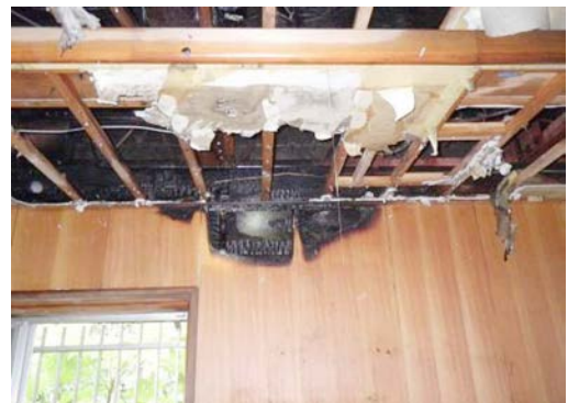
写真6 応接間北西側内壁の状況
