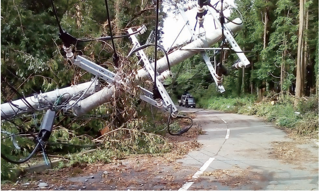
強風により倒壊した電柱 写真提供：千葉県山武市
