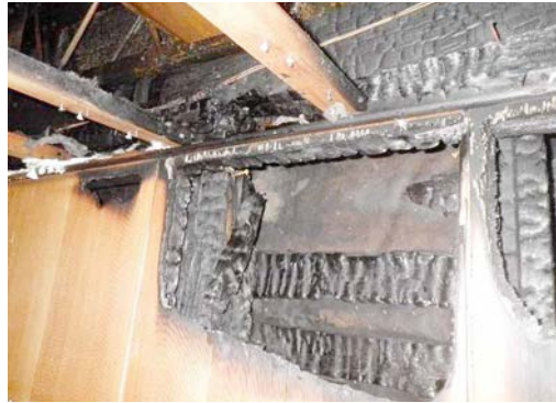
写真7 応接間北西側内壁の状況
