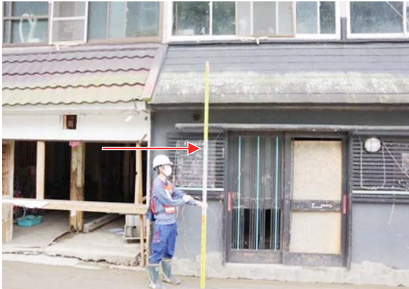
写真1 天ヶ瀬での洪水痕跡
