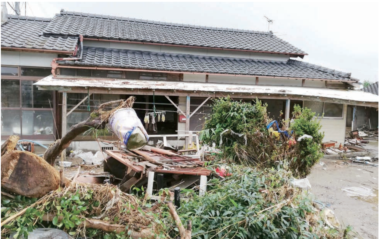
浸水による住家被害 川辺川と球磨川との合流地点付近 撮影年月日：2020年7月16日
