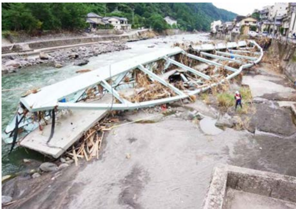
写真2 新天ヶ瀬橋の落橋
