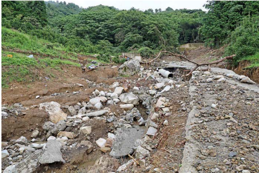
図6 芦北町女島地区天見岳の治山堰堤（写真右奥）下流部での土石流による侵食状況。
