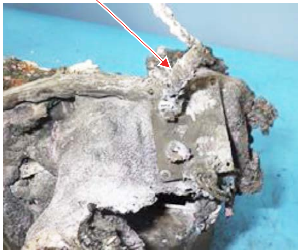
写真8 DC12V出力ポートの状況
