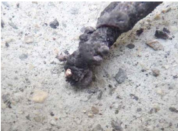
写真3 ACアダプター側の断線箇所の状況
