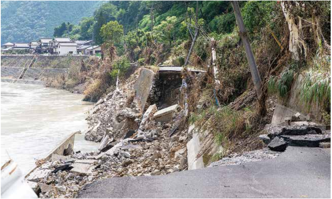
芦北町：護岸ごと流された県道 写真提供：熊本県芦北町
