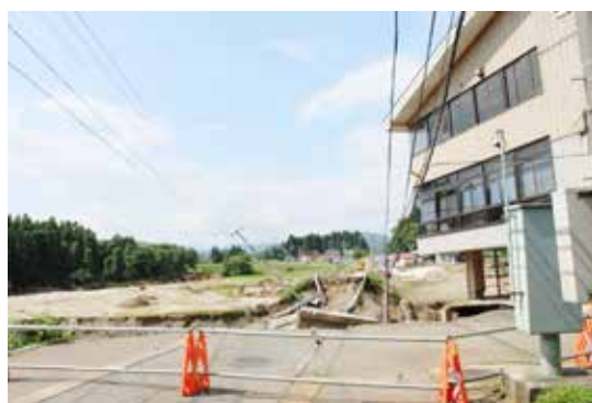
図7 崩落した大巻橋（飯豊町）
