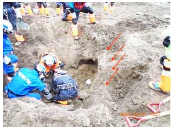
図2 掘削訓練時に生じた亀裂（その後崩落した）
