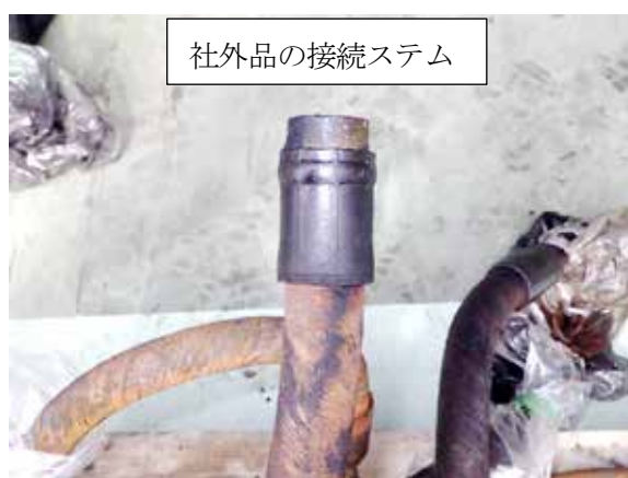
写真11：左クローラー走行用油圧ホースの状況
