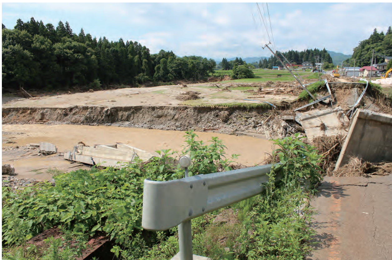
山形県飯豊町 - 白川にかかる大巻橋の崩落現場 (2022年8月撮影)
