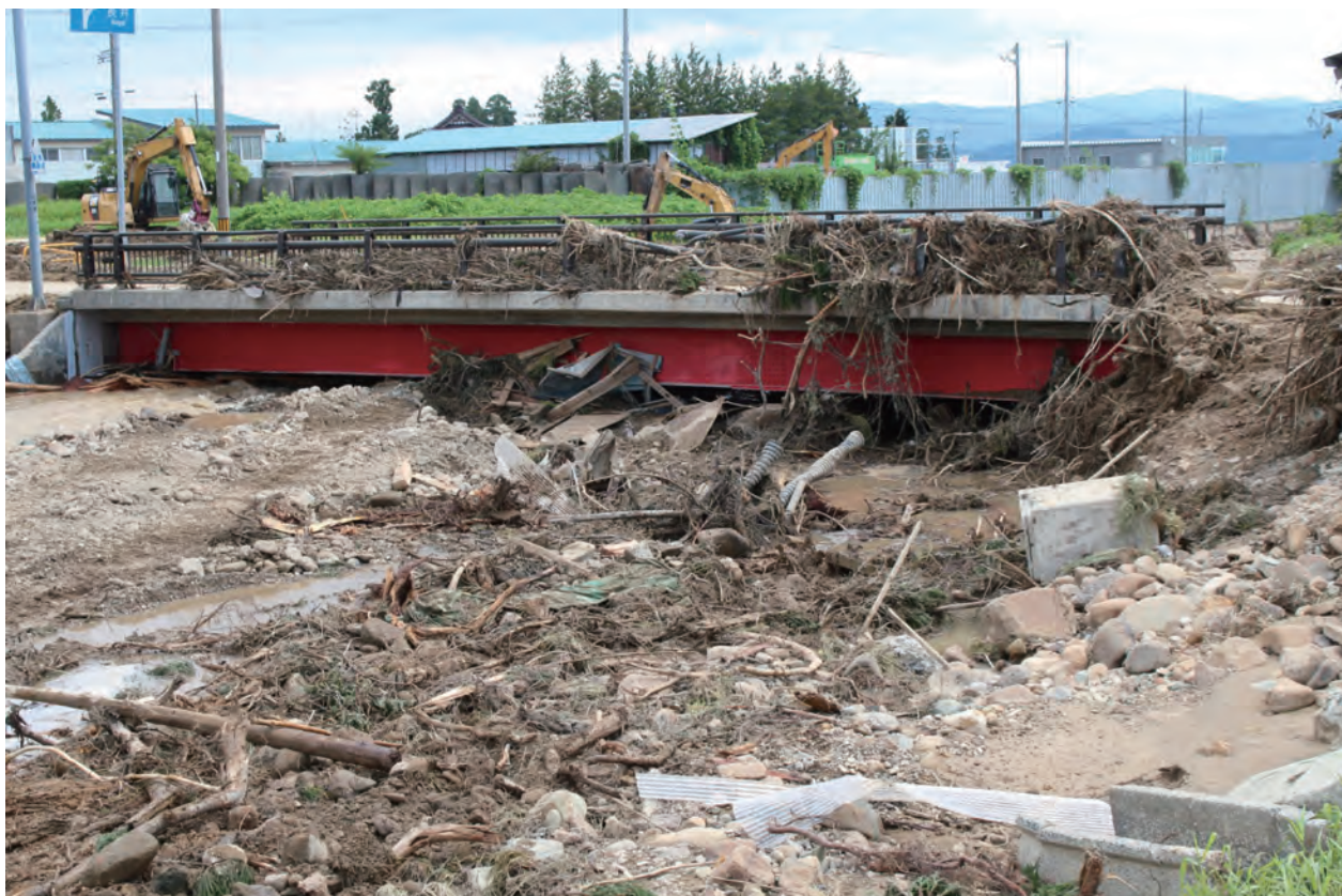
山形県飯豊町 (菰生川) - 流木等が堆積した橋の欄干と、土砂が堆積した河床 (2022 年 8 月撮影)
