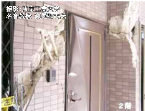
写真5 損傷した集合住宅の間仕切り壁とドア（2005年福岡県西方沖地震）
