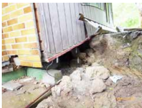
写真3 活断層変位により大きく変形した木造住宅 (2011年福島県浜通り地震)
