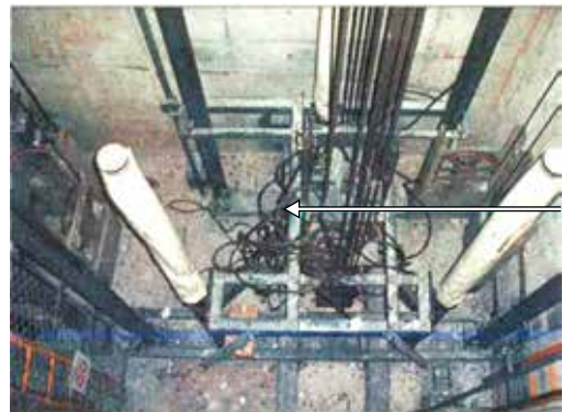
写真6 超高層建築で切断したエレベータのコンペンロープ（2011年東日本大震災）
