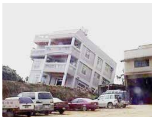
写真10 大規模な縦ずれ断層変位で傾斜したRC造住宅(後に修復、1999年台湾・集集地震)
