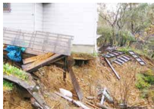
写真4 傾斜地盛土の滑落で傾斜した木造住宅 (2004年新潟県中越地震)
