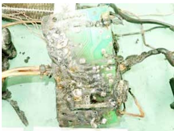
【写真20 焼損品：電源基板】
