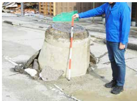
1.5メートル浮き上がったマンホール（輪島市）
