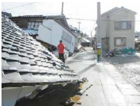
倒壊した木造家屋（輪島市）
