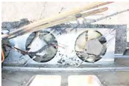
(写真8) コンデンシングファンの状況
