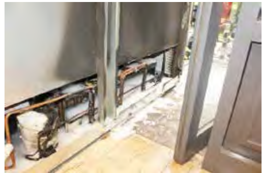
(写真1) 冷蔵ショーケースの状況
