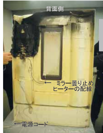
写真 洗面化粧台背面側
