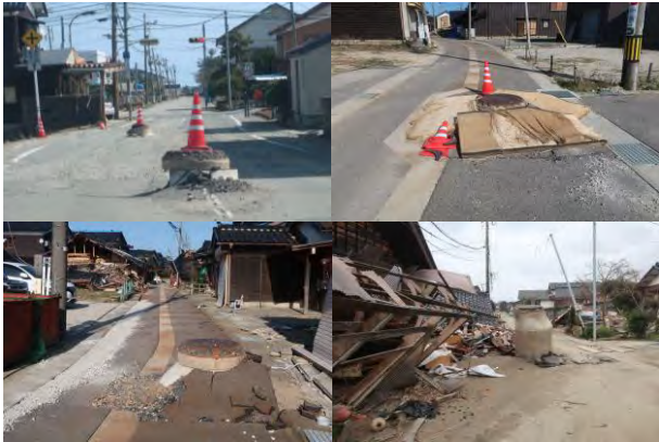
図2 車道路面に突出したマンホール
