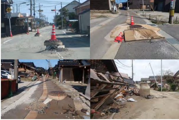
図2 車道路面に突出したマンホール
