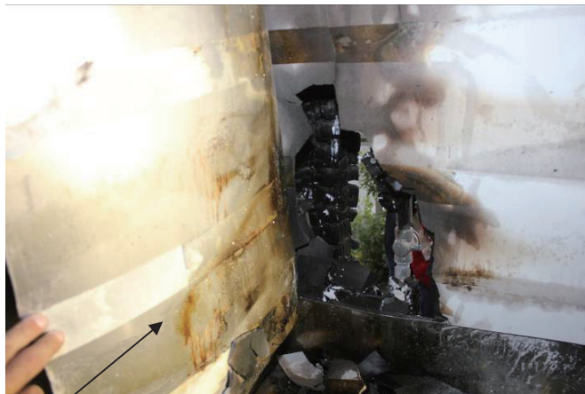
ステンレス板裏面の変色 石膏ボードの焼け崩れ箇所
