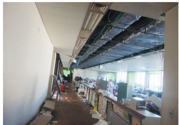
崩落した庁舎1階天井
