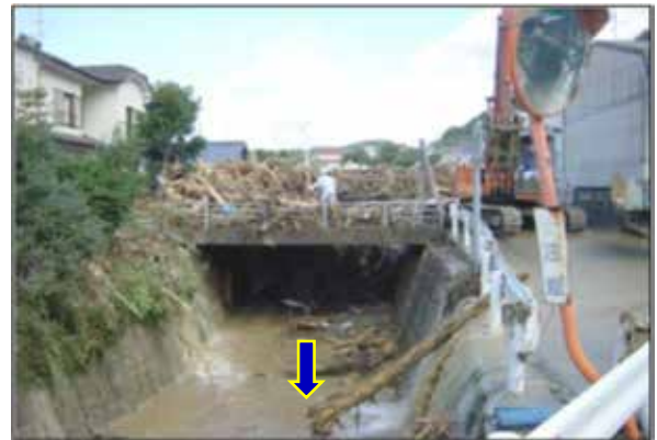
図3 愛媛県西条市長谷川における流木による橋梁の閉塞と周辺への洪水氾濫(2004年9月台風21号による災害、愛媛県提供)
