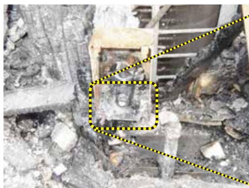
写真5 居室東側角ヒューズコック周囲
