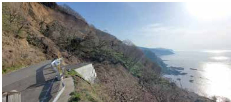
写真3 地すべりによって崩落した道路（輪島市ゾウゾウ鼻付近：2024年4月7日青木撮影） 地すべりの移動体の下方に崩落した道路（路面、電柱、ガードレール）が見える
