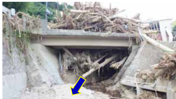
図6 広島県坂町総頭川における流木による橋梁の閉塞と土石流の氾濫(2018年7月豪雨)
