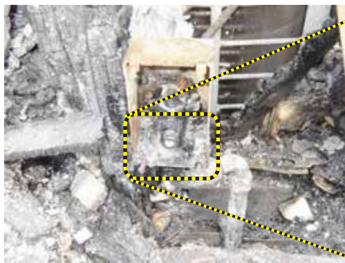
写真5 居室東側角ヒューズコック周囲
