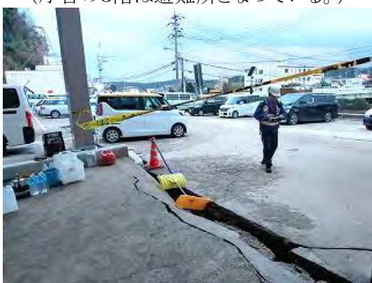
庁舎玄関の地盤被害
