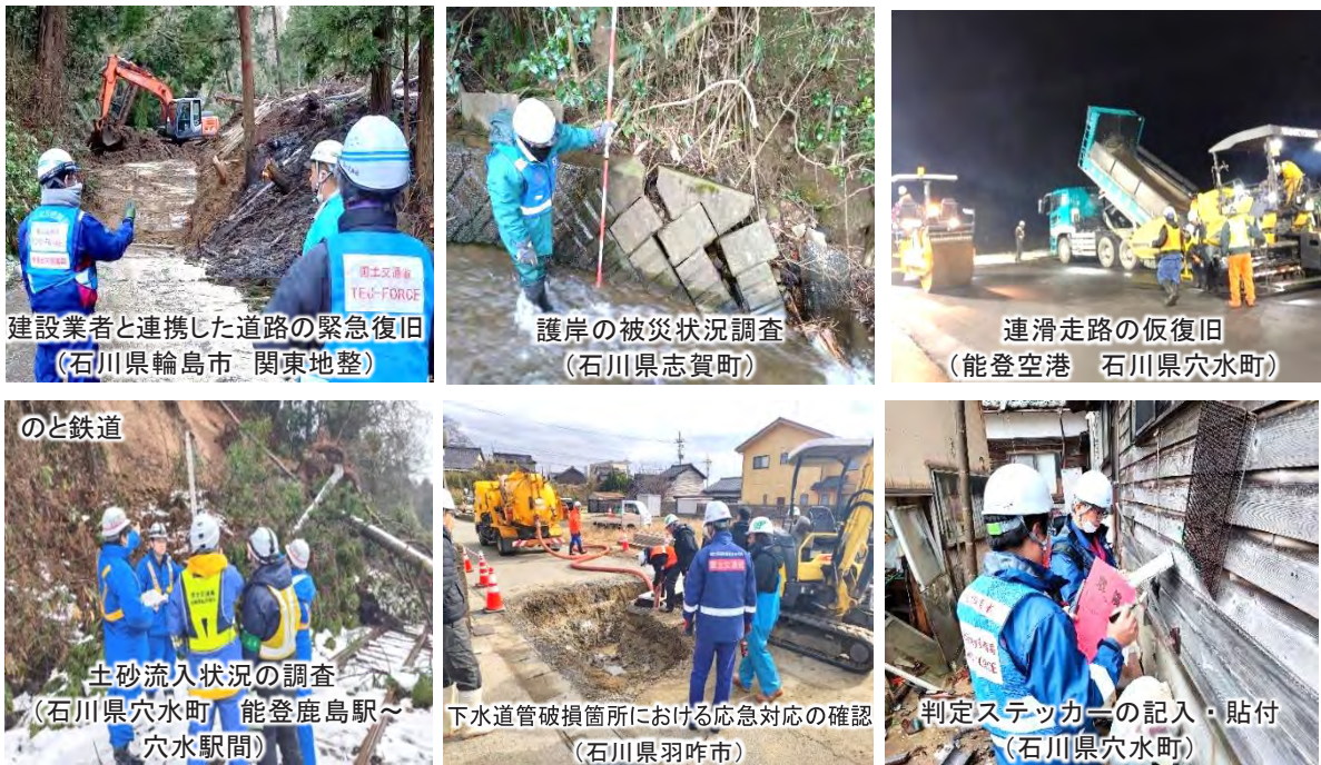
写真6～11 被災状況調査・応急対策・技術的支援等
