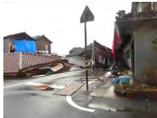
穴水町役場付近の家屋被害
