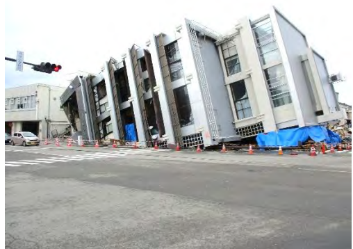
倒壊した鉄筋コンクリートビル
