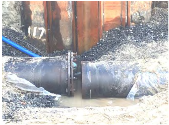
写真4 送水管の破損 (七尾市内)
