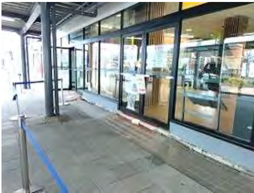
七尾駅舎の被害(液状化による段差)
