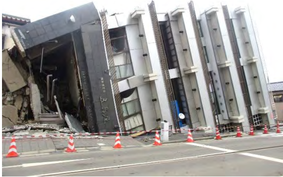
写真2 倒壊したビル（輪島市）
