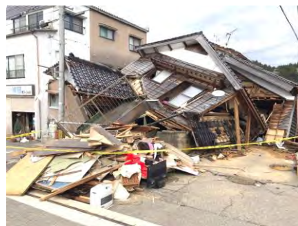
写真1 穴水町市街地の様子
