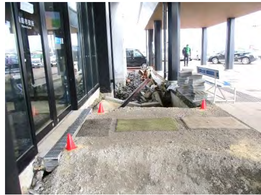
段差の生じた庁舎入り口付近
