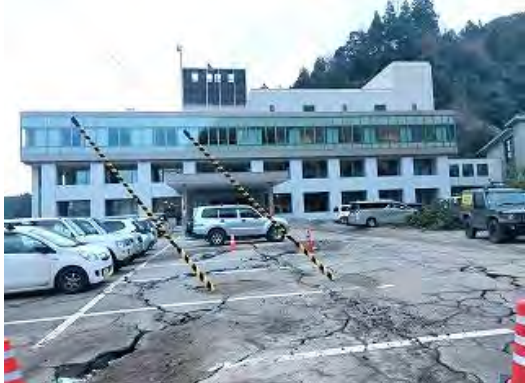
穴水町役場前の駐車場の地盤被害 (庁舎の3階は避難所となっている。)
