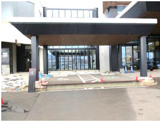
段差の生じた正面玄関
